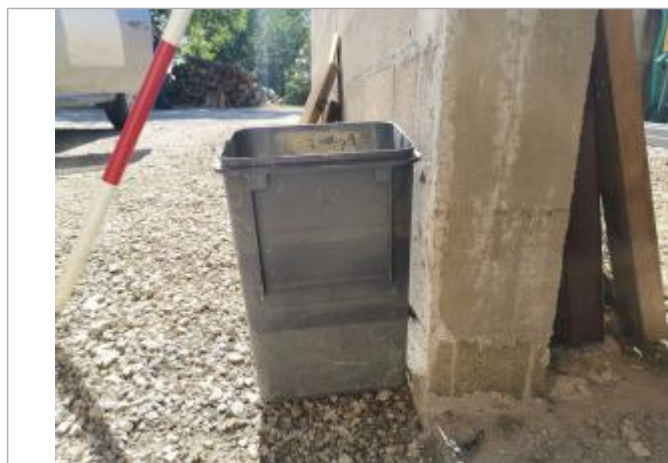
Trace sur le mur - Photo © AGERIN
