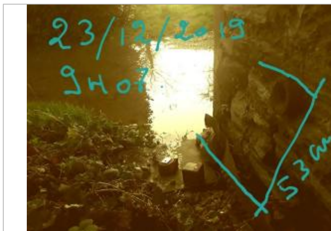
Trace inondation décembre 2019 et repère de nivellement IGN
