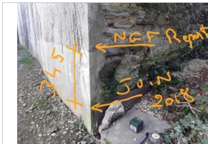
Trace inondation juin 2018 et repère de nivellement IGN
