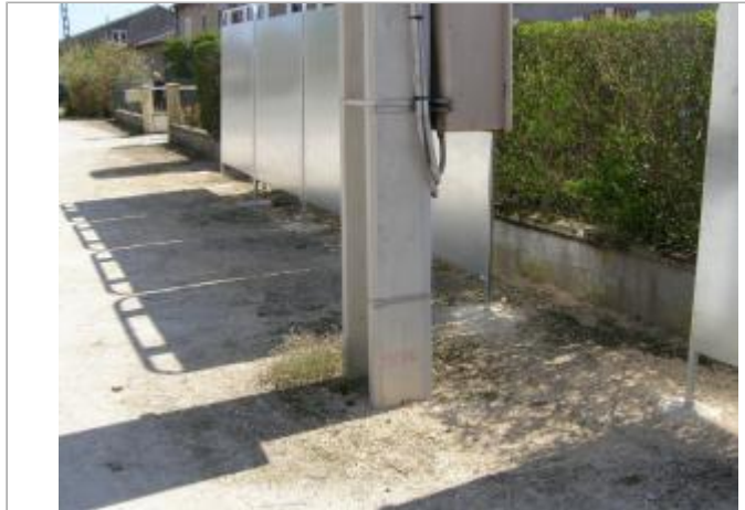
poteau EDF en face de la mairie
