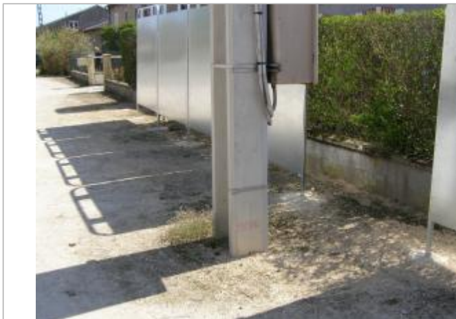
poteau EDF en face de la mairie
