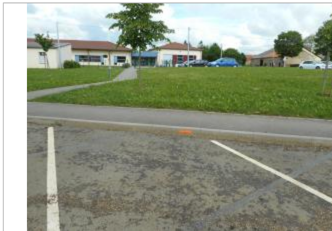
bordure de trottoir
