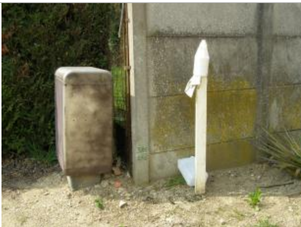
Trait de peinture des plus hautes eaux, poteau d'angle de la clôture béton.
