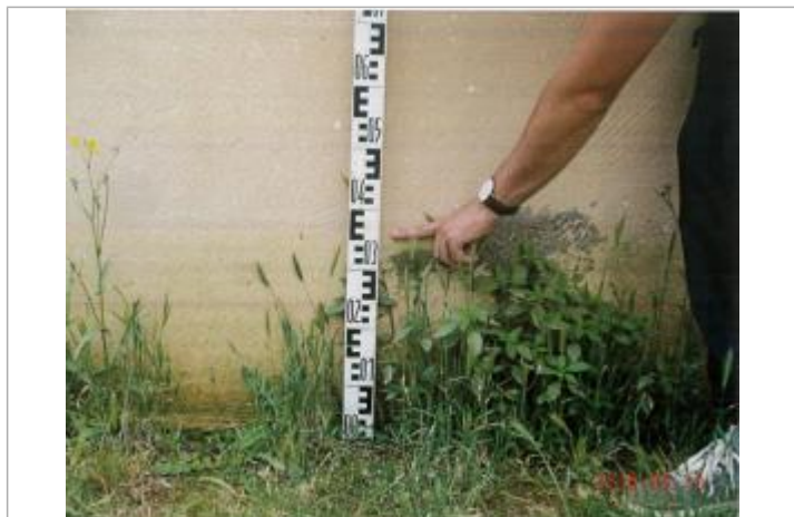
Laisse de crue sur le mur à 35 cm du sol.
