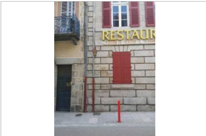
Marques peintes sur la façade
