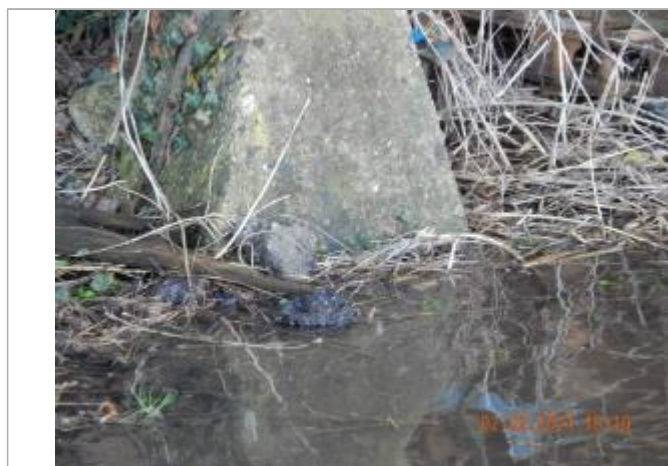
marque de peinture sur la base du pilier
