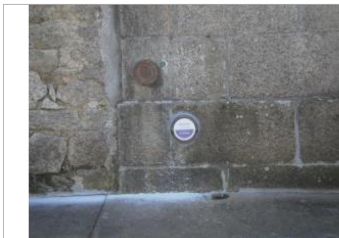
Repère normalisé de l'inondation du 23 janvier 1995
