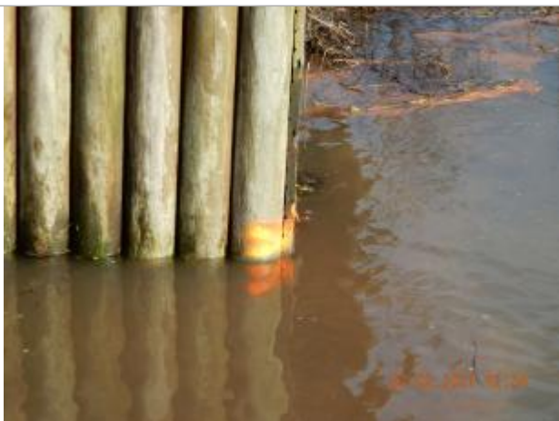
Trace de peinture sur le mur
