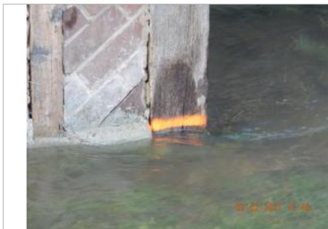
Trace de peinture sur le bâtiment
