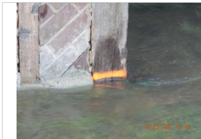
Trace de peinture sur le bâtiment
