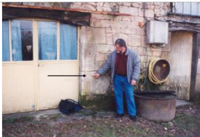
Vue sur un bâtiment qui porte un repère de crue non daté
