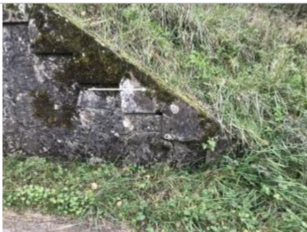
Vue sur le passage de la D 80 sous la voie ferrée. La maçonnerie du passage porte un repère de crue non daté
