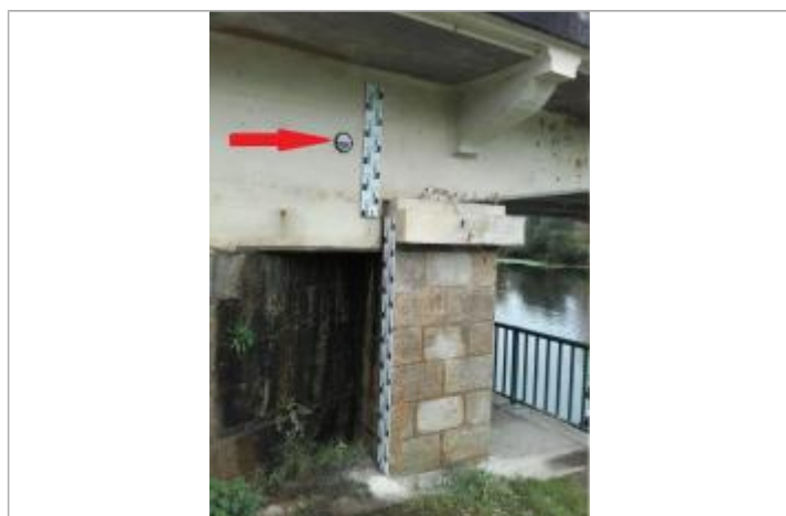
Repère normalisé de janvier 1995 et échelle limnimétrique
