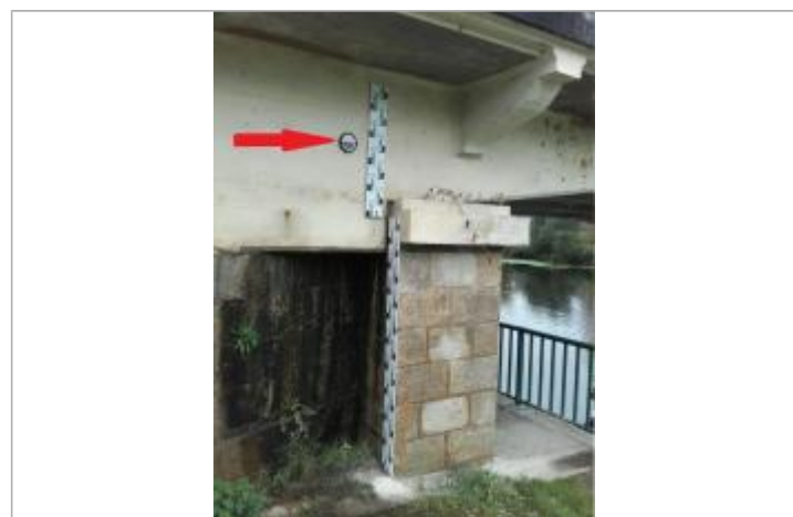
Repère normalisé de janvier 1995 et échelle limnimétrique
