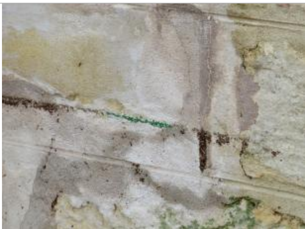
Marque sur le mur en L, sur la culée en amont rive droite
