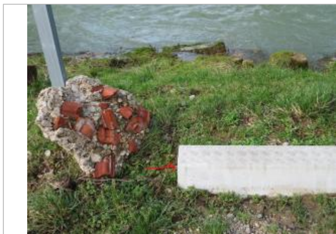
Coin haut gauche de la margelle du point d'aspiration
