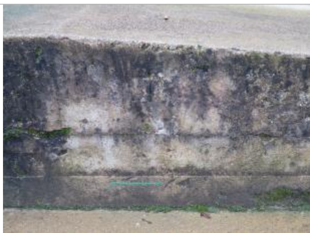
Marque sur le bas de la rampe d'accès à la salle, proche de la cage de bonbonnes de gaz
