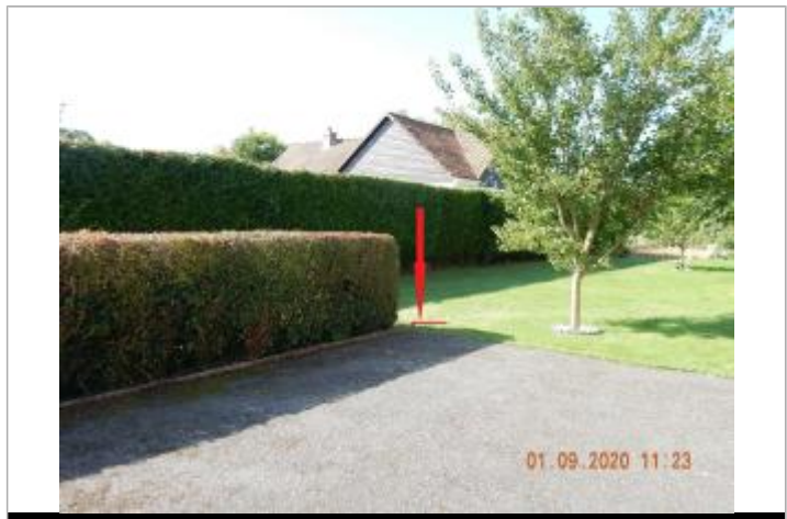
Laisse de crue sur une bordure en ciment, à 10 cm/sol, située dans la cours devant la maison.
