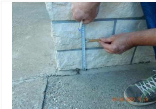
Laisse de crue 18 cm au dessus du sol située sur la facade(Nord) face au portail de la maison
