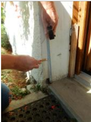
Laisse de crue 18 cm au dessus de la margelle située devant la porte d'entrée du pavillon
