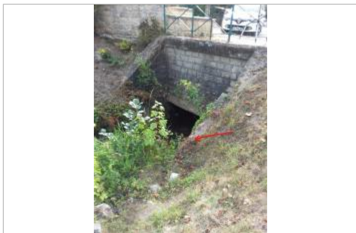
Marque jaune sur le mur en retour de la tête de l'ouvrage (buse), RG
