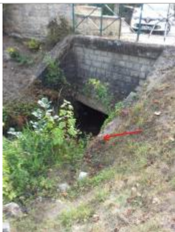
Marque jaune sur le mur en retour de la tête de l'ouvrage (buse), RG
