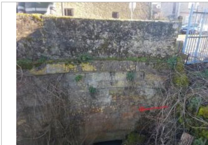
Marque rouge sur la culée du pont, dans le petit renforcement, aval RG
