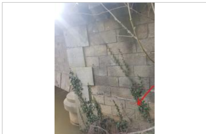
Marque rouge sur la culée amont du pont en rive droite
