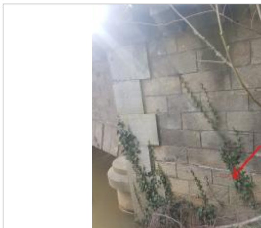
Marque rouge sur la culée amont du pont en rive droite
