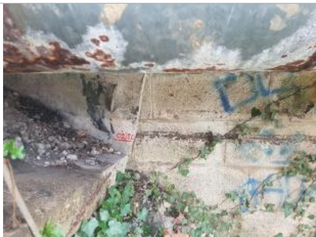
Marque rouge sous le tuyau sur la culée aval du pont, RD
