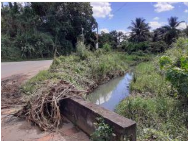
Laisse d'inondation (branchage) ravine Grand Boucan
