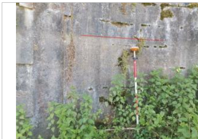
Trace sur le parement - Photo © AGERIN
