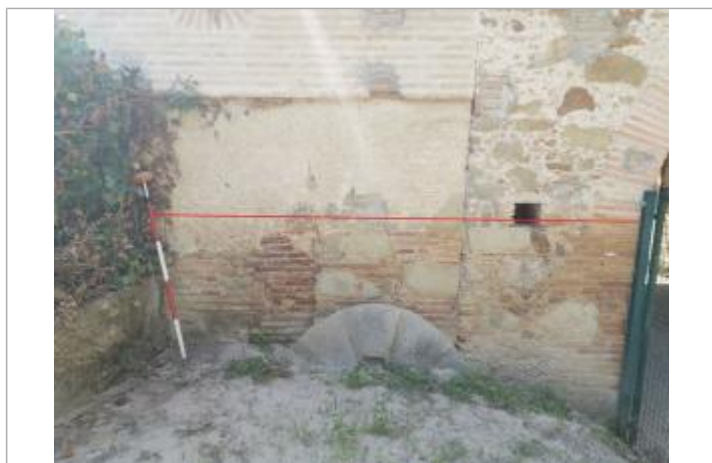
Trace sur mur - Photo © AGERIN
