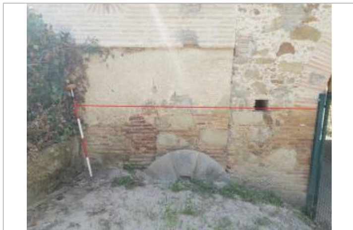
Trace sur mur - Photo © AGERIN
