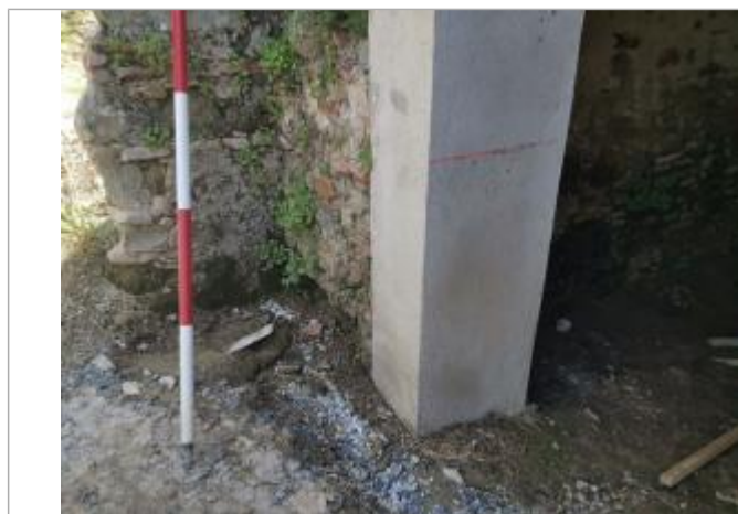
Trace sur mur - Photo © AGERIN
