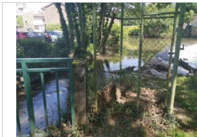
Débris sur le grillage - Photo © AGERIN
