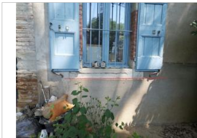
Trace sur le mur - Photo © AGERIN
