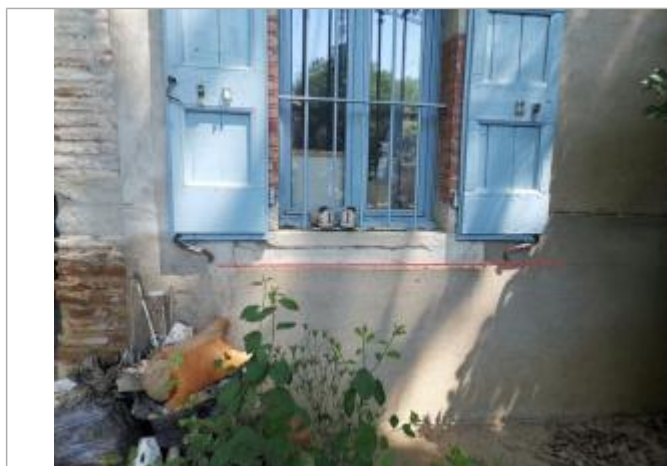
Trace sur le mur - Photo © AGERIN
