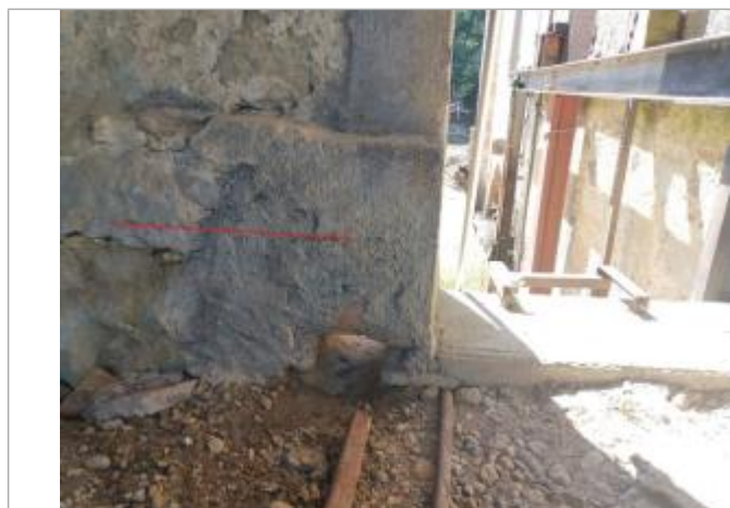
Trace sur le mur - Photo © AGERIN
