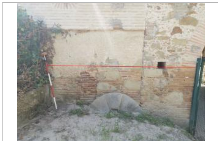
Trace sur mur - Photo © AGERIN
