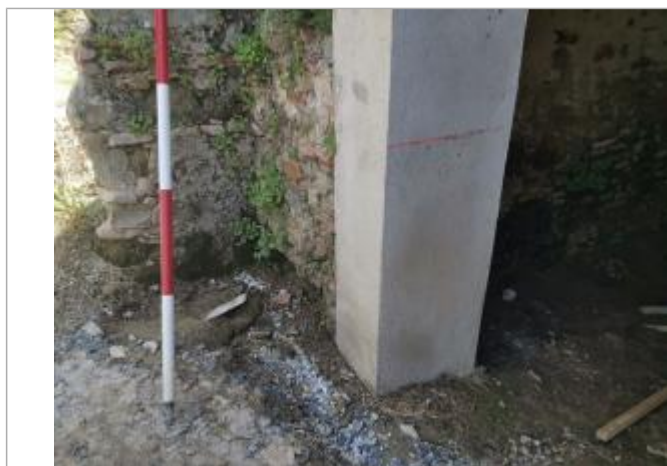
Trace sur mur - Photo © AGERIN
