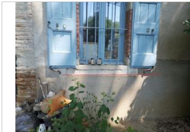
Trace sur le mur - Photo © AGERIN
