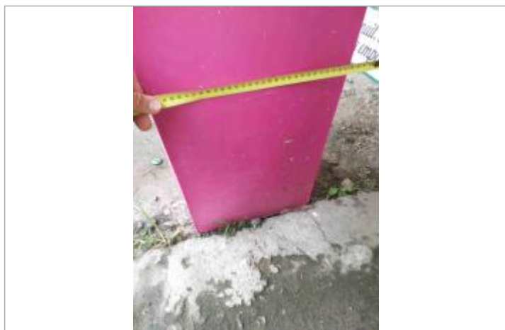
Trace de PHE sur un poteau
