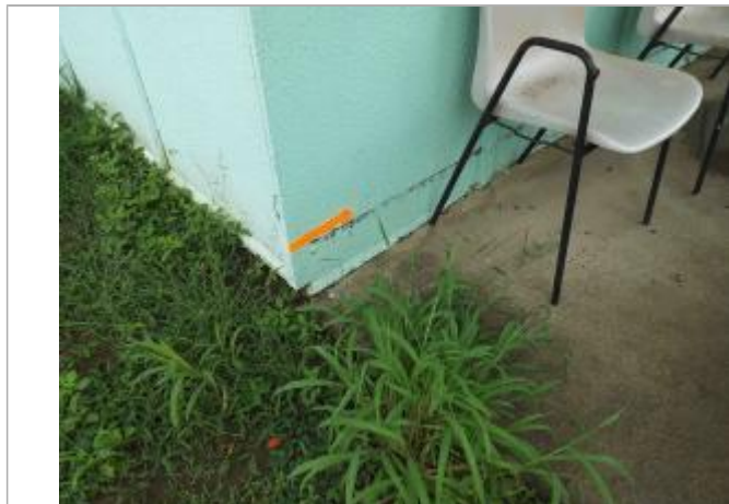
Laisse d'inondation sur mur crépis
