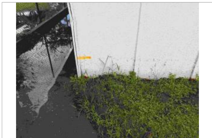
Laisse d'inondation sur mur en crépis
