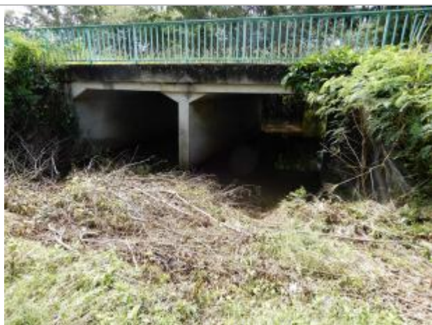
Aplatissage de la végétation - Pont de Deville
