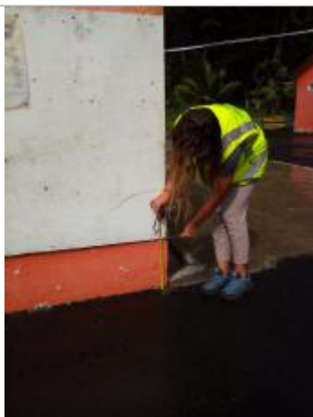
Trace d'humidité sur le mur extérieur
