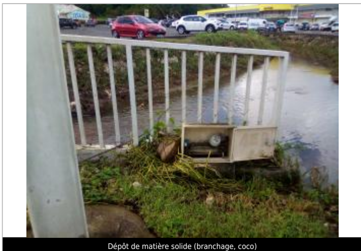
Dépôt de matière solide (branchage, coco)
