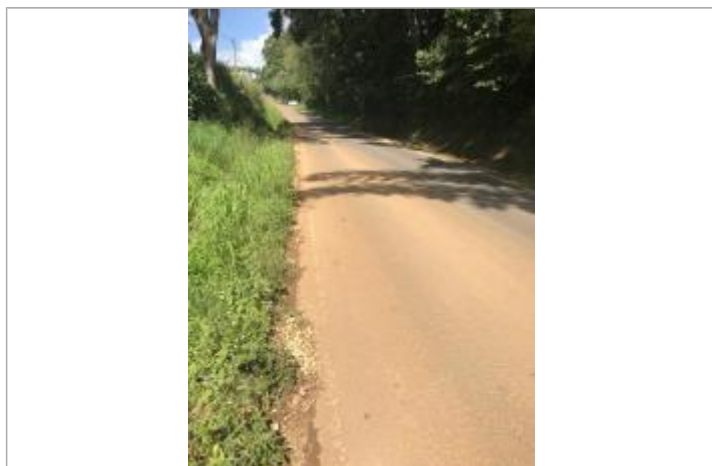
Dépôt de boue sur la voirie
