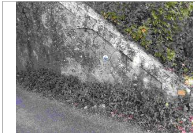
Le Merdans au Moulin de Gary (chemin d'accès au cimetière sous voie SNCF)
