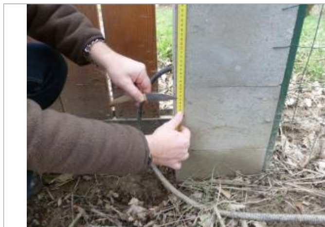
Trace de laisse portail - Photo ©DDT47
