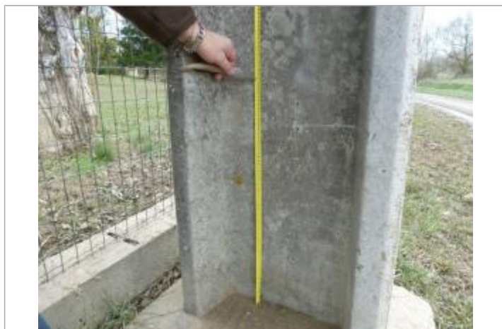
Trace de laisse poteau - Photo ©DDT47
