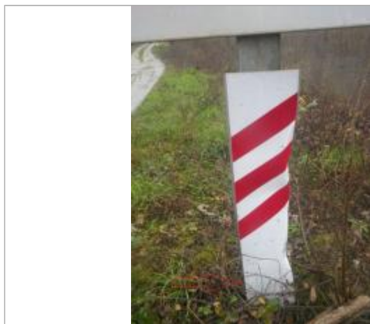
Trace de laisse sur panneau signalisation - Photo ©AGERIN
