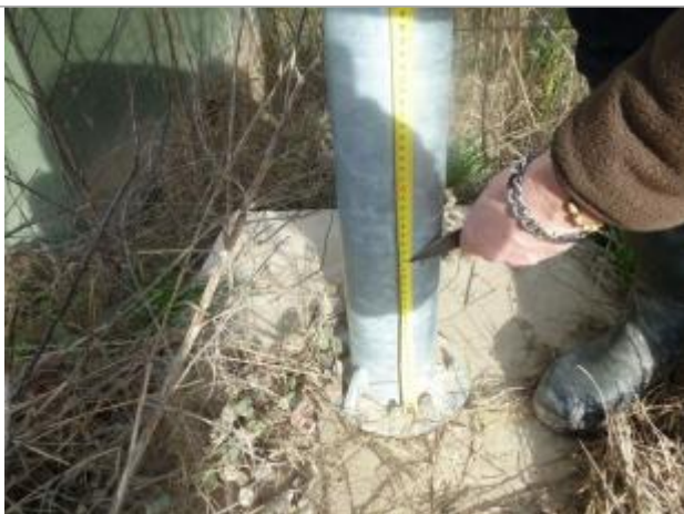
Laisse de crue sur le poteau - Photo ©DDT47
